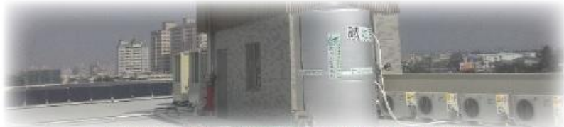
50片太陽能+高溫熱泵 岡山和春 養護中心
